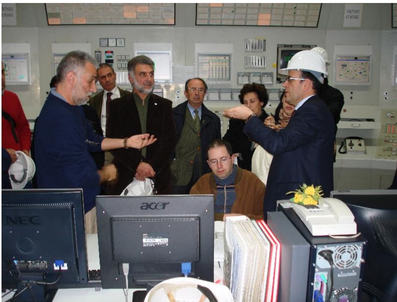
(Momento di relazione sui pannelli di comando della Sala Quadri)
